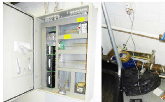
Energiankulutuksen seurannan tehostaminen tarkoittaa uusien mittauspisteiden kytkemistä automaatiojärjestelmään. Kuvassa oikealla koko kiinteistön vesimittari jossa on pulssilähtö vedenkulutuksesta olemassa mutta sitä ei ole kytketty automaatiojärjestelmään. Kuvan vasemmalla puolella on viereisen automaatioalakeskuskaappi, jossa on vielä vapaata tilaa.
