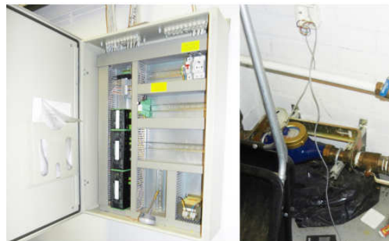
Energiankulutuksen seurannan tehostaminen tarkoittaa uusien mittauspisteiden kytkemistä automaatiojärjestelmään. Kuvassa oikealla koko kiinteistön vesimittari jossa on pulssilähtö vedenkulutuksesta olemassa mutta sitä ei ole kytketty automaatiojärjestelmään. Kuvan vasemmalla puolella on viereisen automaatioalakeskuskaappi, jossa on vielä vapaata tilaa.
